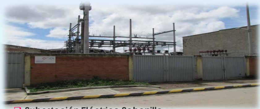
■ Subestación Eléctrica Sabanilla.
