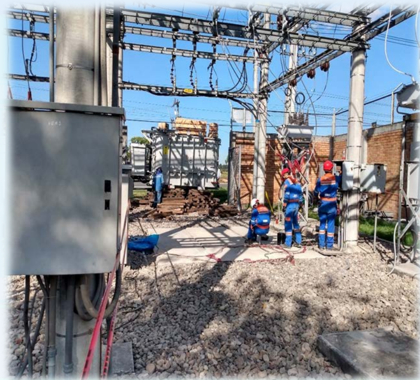
■ La Subestación La Punta.
