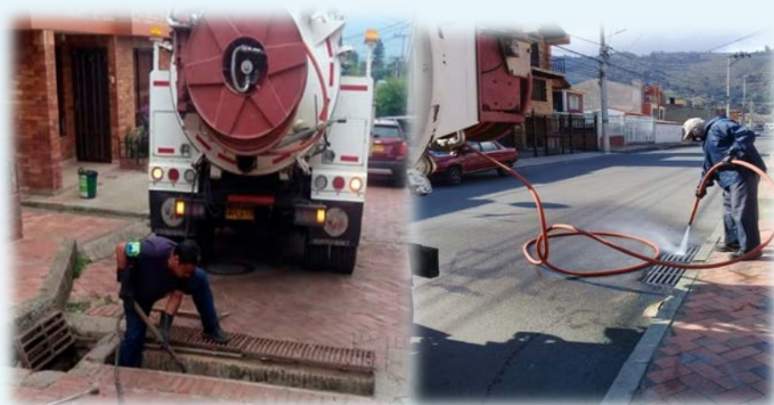
Coberturas en alcantarillado Municipio de Tenjo Fuente: Empresa de Servicios Públicos EMSERTENJO.
